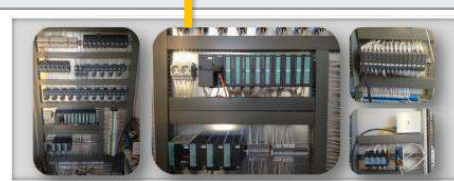
ШКАФ УПРАВЛЕНИЯ УПСВ
